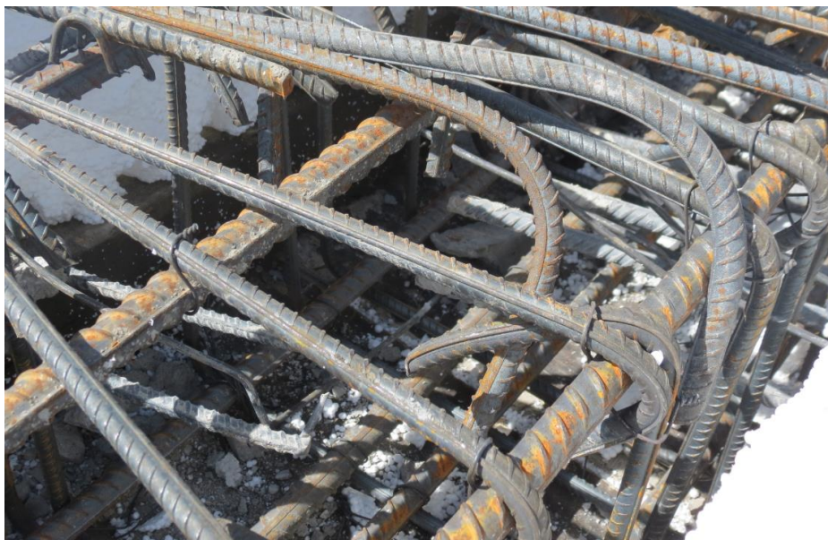
شکل ۱۵. قلاب نامناسب آرماتورهای تیر.
